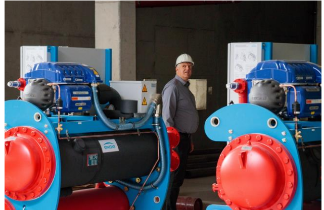
Die Klimatechnik ist ganz oben untergebracht. Foto: © sis/utg
